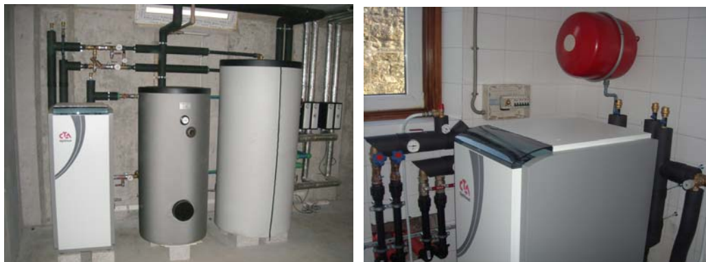
Instalaciones geotérmicas para ACS y calefacción en viviendas unifamiliares
