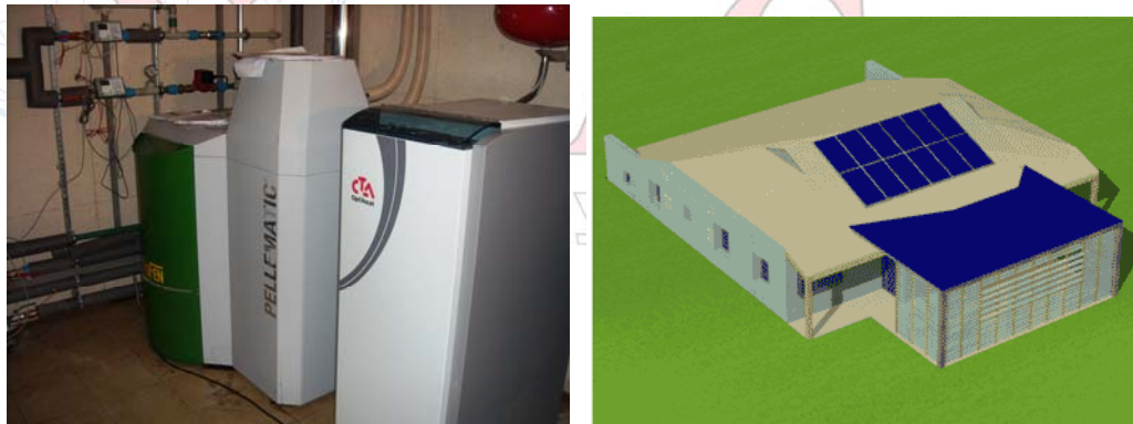
Instalación geotérmica y de biomasa en la vivienda bioclimática del parque experimental de Sotavento
