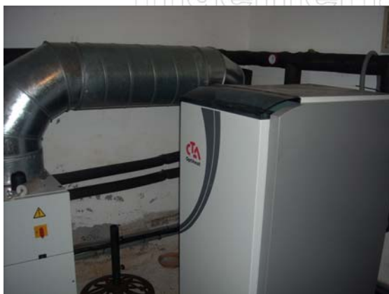
Climatización de piscina con bomba de calor geotérmica
