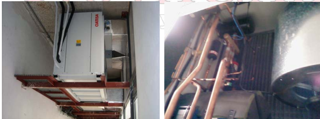
Climatización de un auditorio mediante una climatizadora aire-aire
